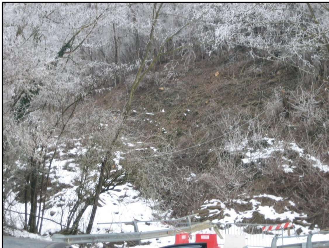
Fig. 3: Fotografia dell'area interessata dal movimento franoso (fascia di contatto tra corpo attivo e quiescente)
